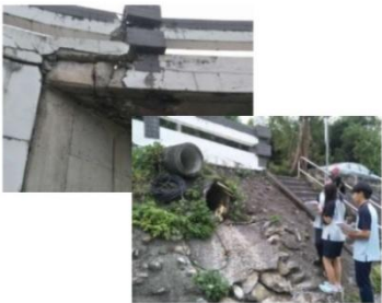
忠烈祠前尚志橋因地震嚴重龜裂，水管明顯壓扁，與 1951 地表破裂處相同
