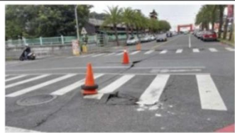
舊花東鐵路軌道-福町路沿線路面破裂
