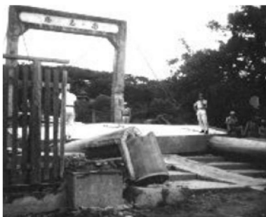
照片 1-6 當年大地震後破裂面經過忠烈祠牌樓造成柱斷梯毀景象
