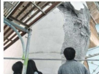
七星橋橋墩嚴重受損。
