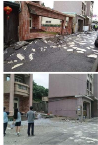
七星街災損嚴重，小組考察時已部分拆除，上圖為網路照片 劉彥求攝
